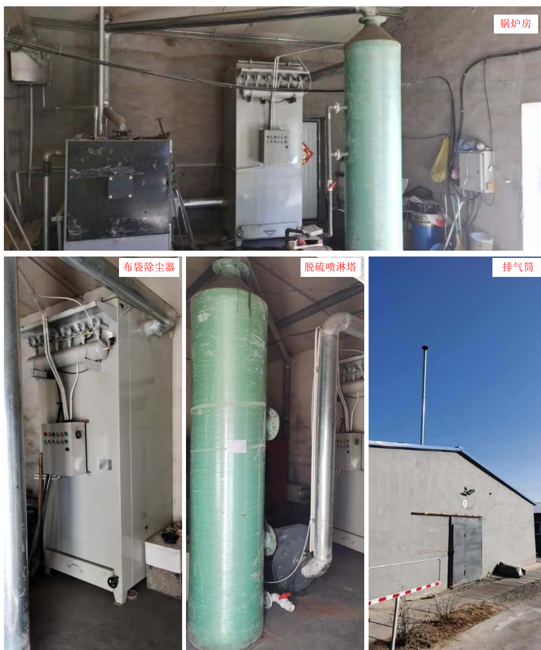
图 3-1 锅炉房及烟气治理照片
