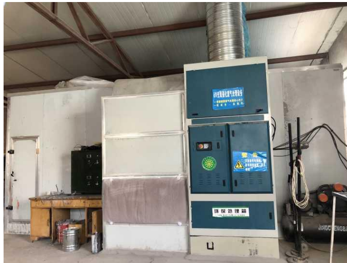
图 2 光氧设备实际照片
