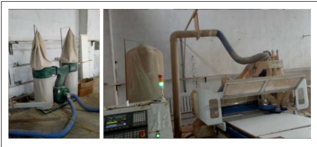
图3 项目设备自带除尘设施
