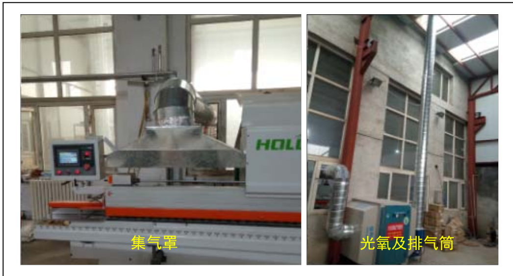
图2 集气罩、光氧设备及排气筒实际照片
