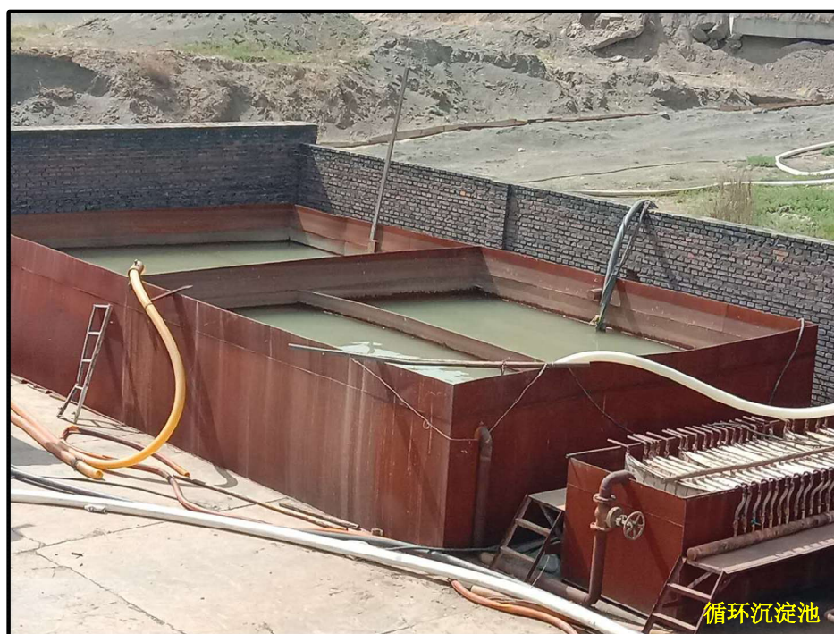
图3-3 循环沉淀池实物图
