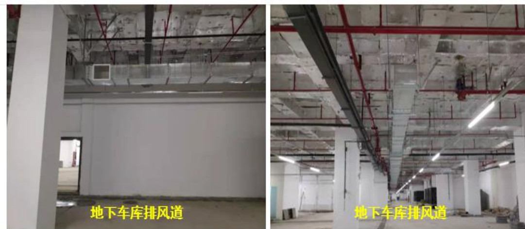
图 4-3 地下车库通排风设施现场照片
