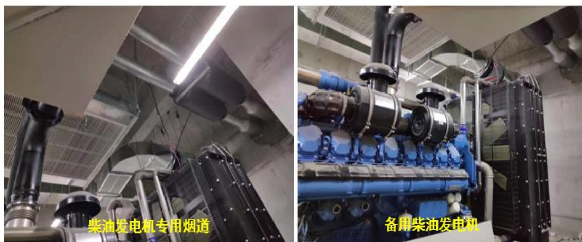
图 4-2 备用发电机现场照片
